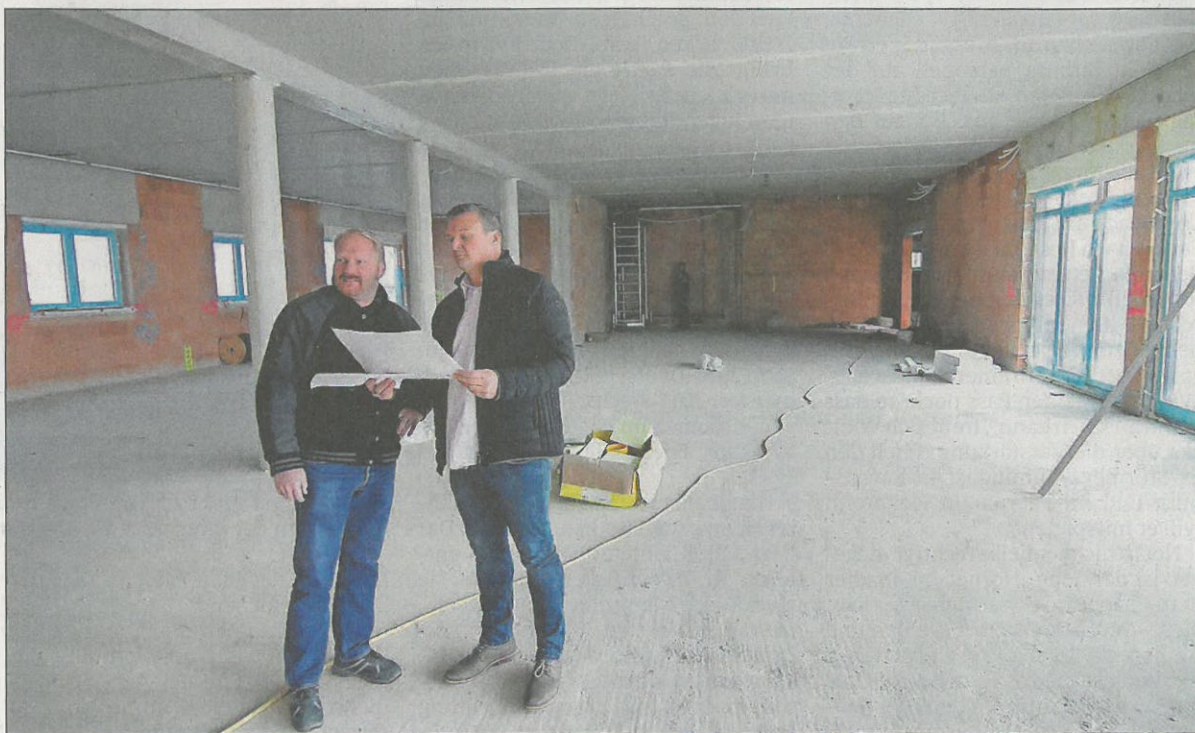
Werko-Chef Heiko Hofer (rechts) und Bauleiter Christian Krause in einem der künftigen Ausstellungsräume. Der Pavillon für die Haustechnik wird 250 Quadratmeter groß sein. Fünf Pavillons sind vorgesehen.
